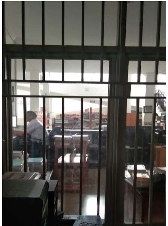
Trali Keamanan Ruang Server
