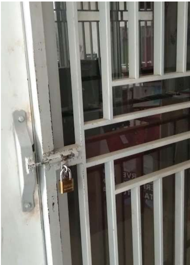
Gembok Pintu Ruang Server
