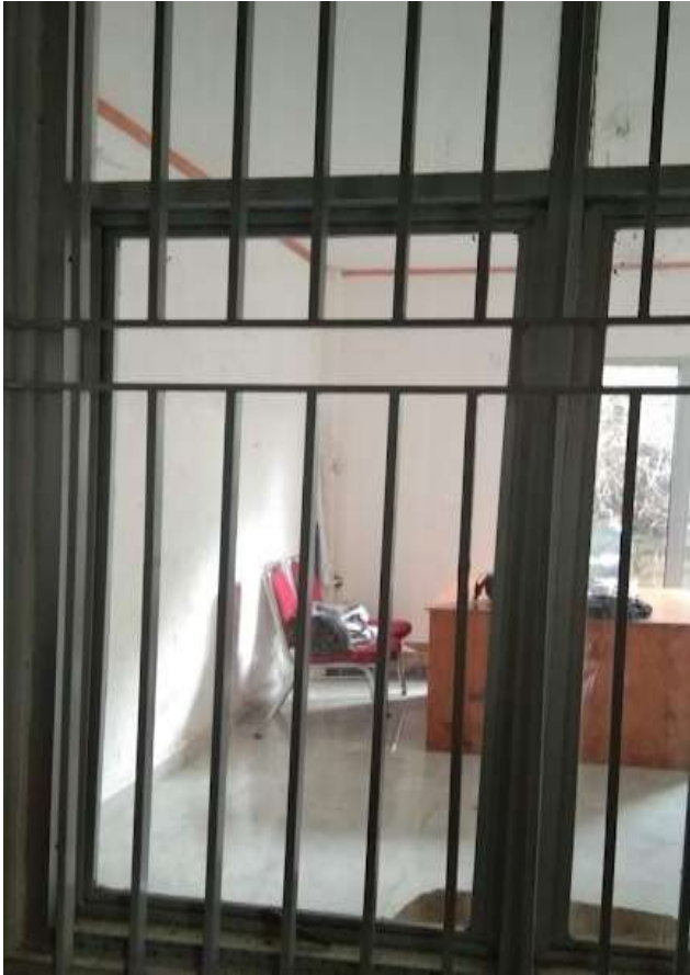
Trali Keamanan Ruang Server
