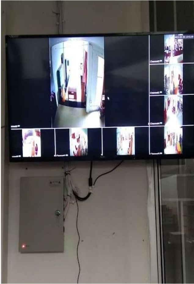
CCTV, lantai I, II masing-masing 3 kamera dan lantai II 2 kamera
