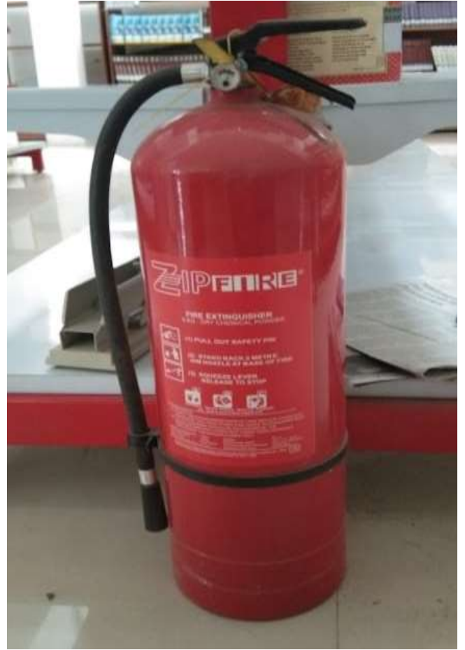
Fire System Pemadam Api, Siaga di Lantai I
